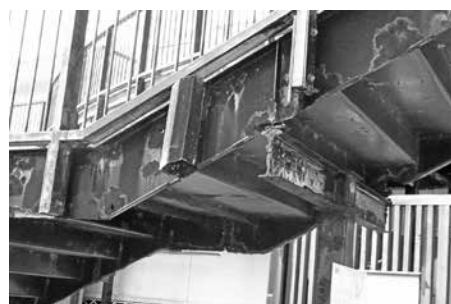
腐食したオープンデッキ
