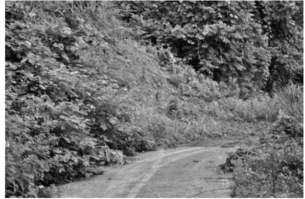
崩壊した林道 (常楽寺線)
