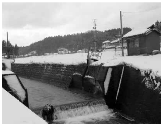
故障した馬草堰
